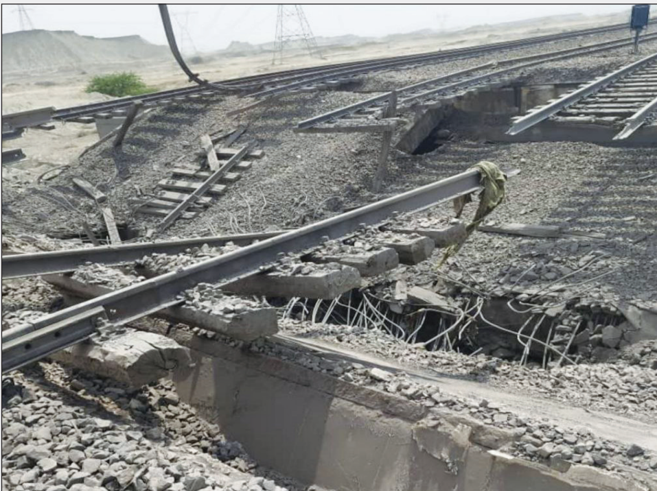
تخریب یک انشعاب راه آهن بندرعباس در پی حمله وحشیانه دشمن
